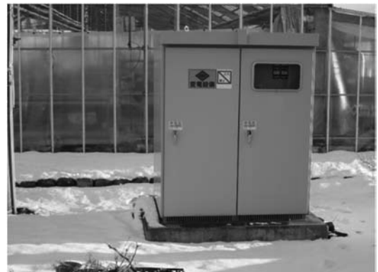
高圧受電設備（キュービクル）
