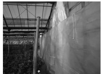
妻面のカーテンの隙間対策②
