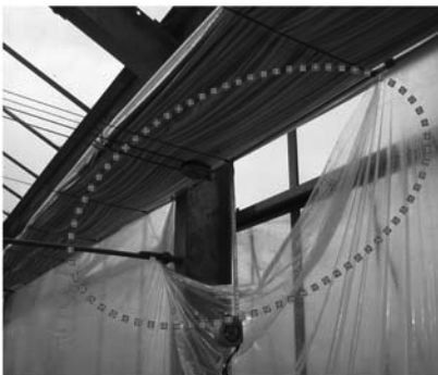
肩部の垂れ下がりによる隙間
