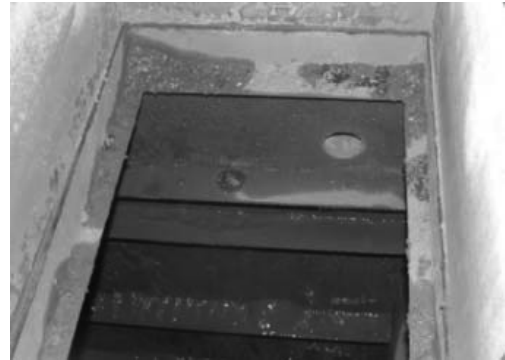
腐食抑制剤を使用していない缶体 （缶体内が腐食し、サビ泥が付着）
