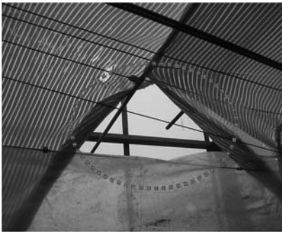
天井カーテンの隙間（妻面）
