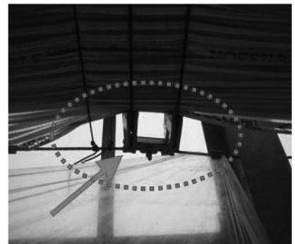
肩部の滑車付近の隙間
