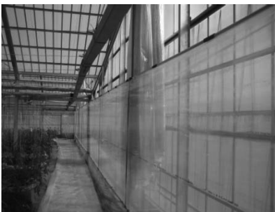
妻面のカーテンの隙間対策①
