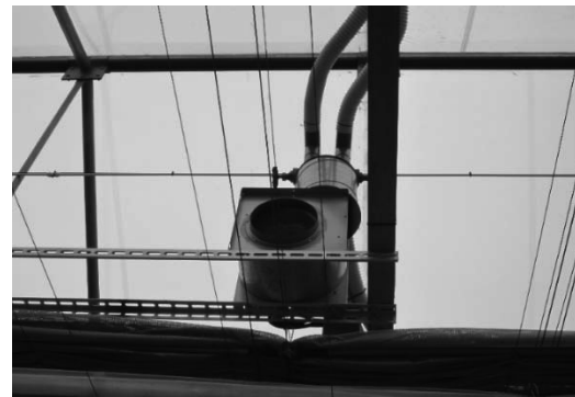
空気膜の加圧のための送風ファン
