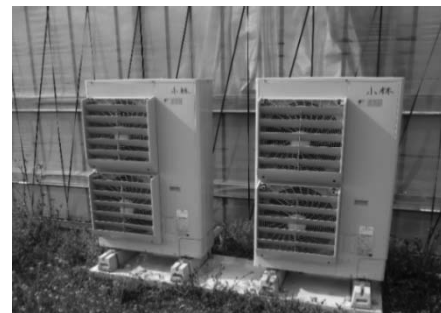
風向ガイドを取り付けた室外機
