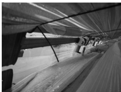
多層カーテン肩部の隙間
