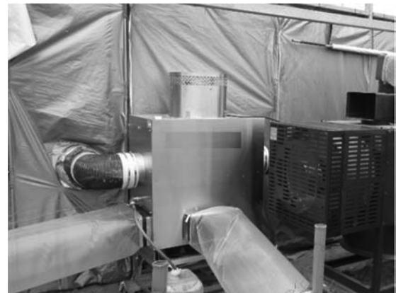
排熱回収装置
