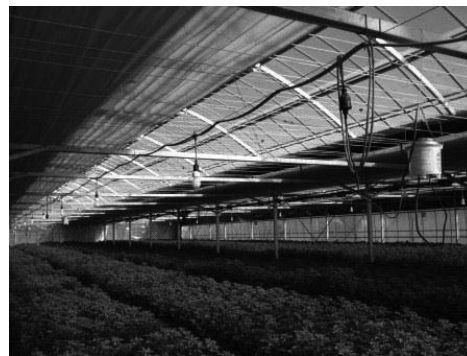
内張カーテンの自動開閉
