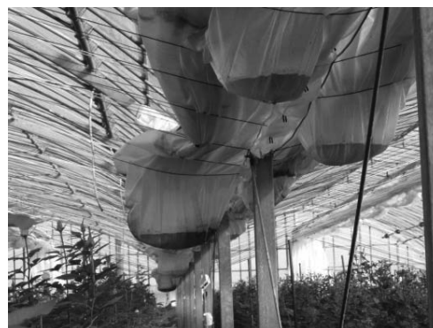
金魚鉢状に膨らんだ内張カーテン
