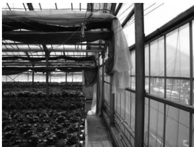
妻面のカーテンの隙間
