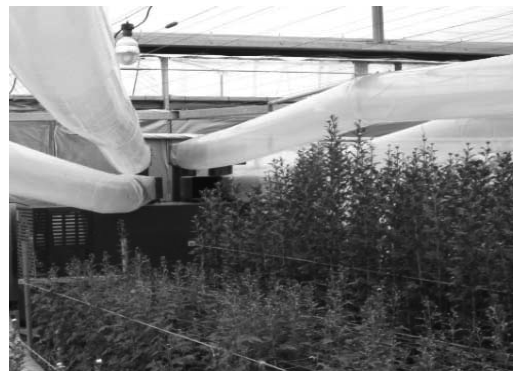
上吹き出しのダクトの設置例
