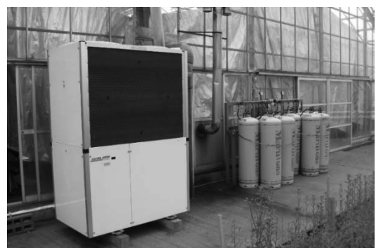
ガスヒートポンプ（室外機）
